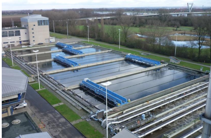
Teilansicht des Klärwerks Düsseldorf-Nord
